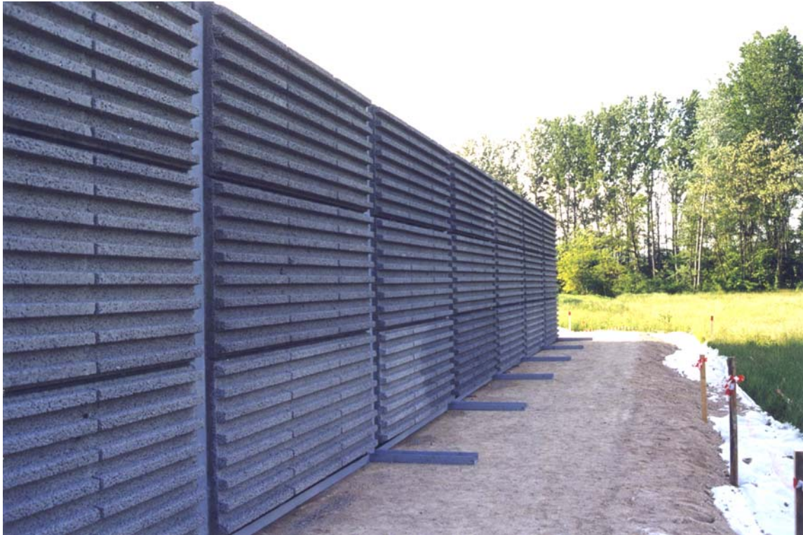
Fig. 10 - Barriera acustica sottile con lato rivestito in pomice. L'altro, rivolto verso la sorgente, è rivestito di materiale fonoassorbente (lana minerale).
